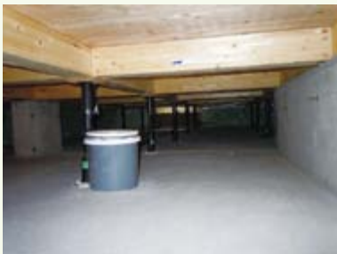
床下側の給気口 (温度で開閉)
