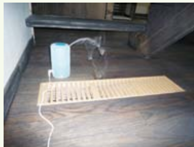
ダウン開口の換気床ガラリ (空気が床下へ落ちている)
