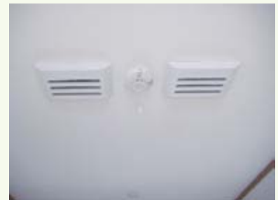
湿度で開閉する2階天井の排気口
